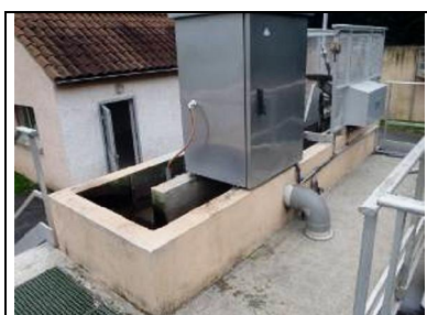
Point de prélèvement entrée : canal avant dégrillage
