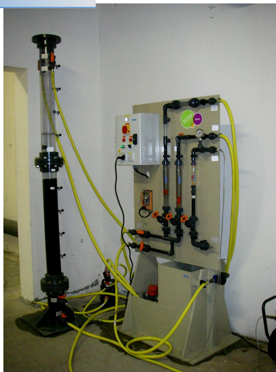
Pilote de charbon activé
