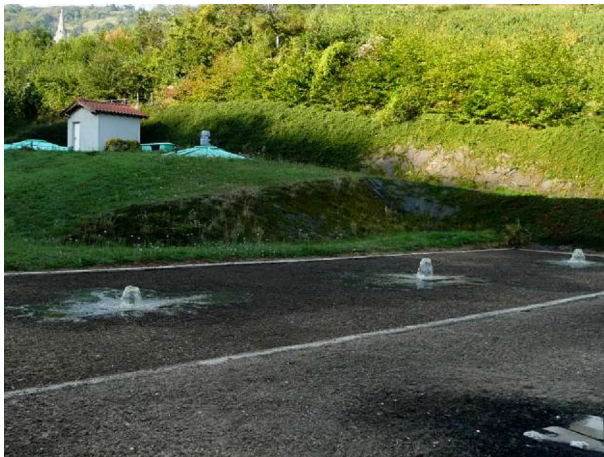
Station de purification de Valfleury située en amont de la ZRV
