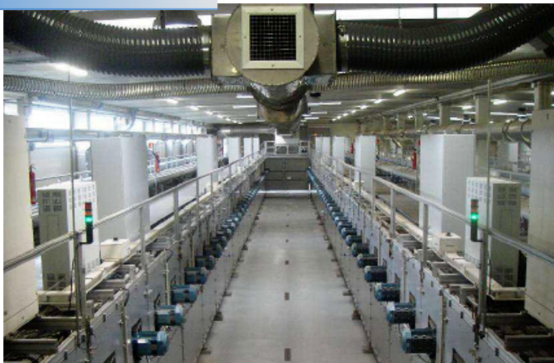
Figure 8 : Deux des sécheurs de la campagne ASE2-Boue
