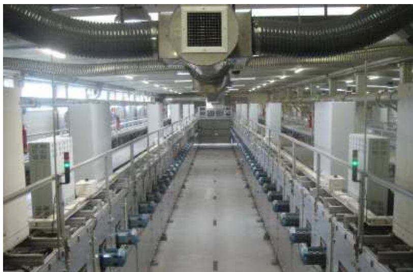
Figure 7 : Deux des sécheurs de la campagne ASE2-Boue
