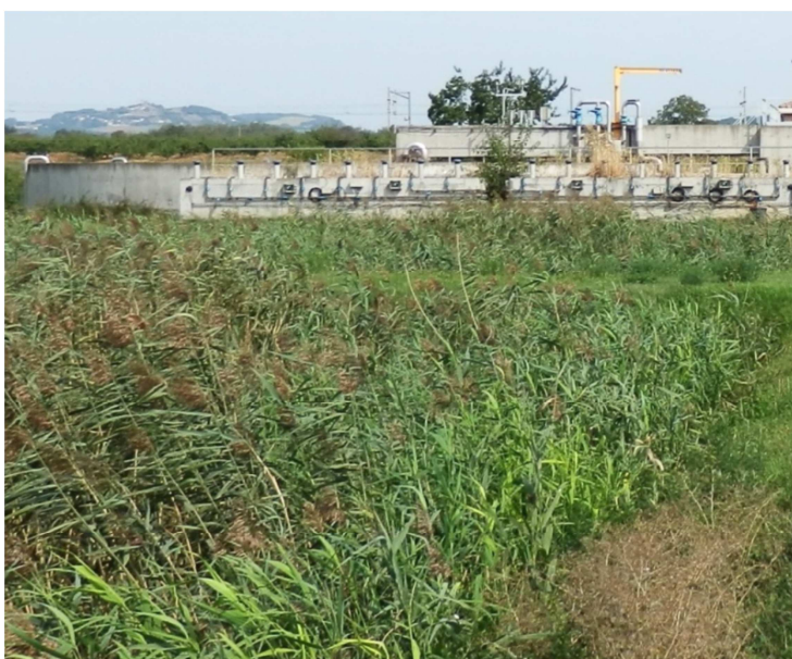
Figure 33 : Lit de séchage de boues planté de roseaux et bassin d'aération de la file eau (arrière-plan) du site Is
